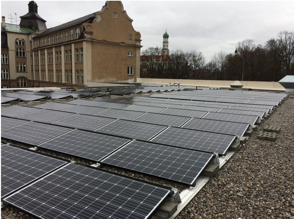
PV-Module auf dem Flachdach der Grundschule „Vor dem Roten Tor“, Bild: Ute Greve, KEM
